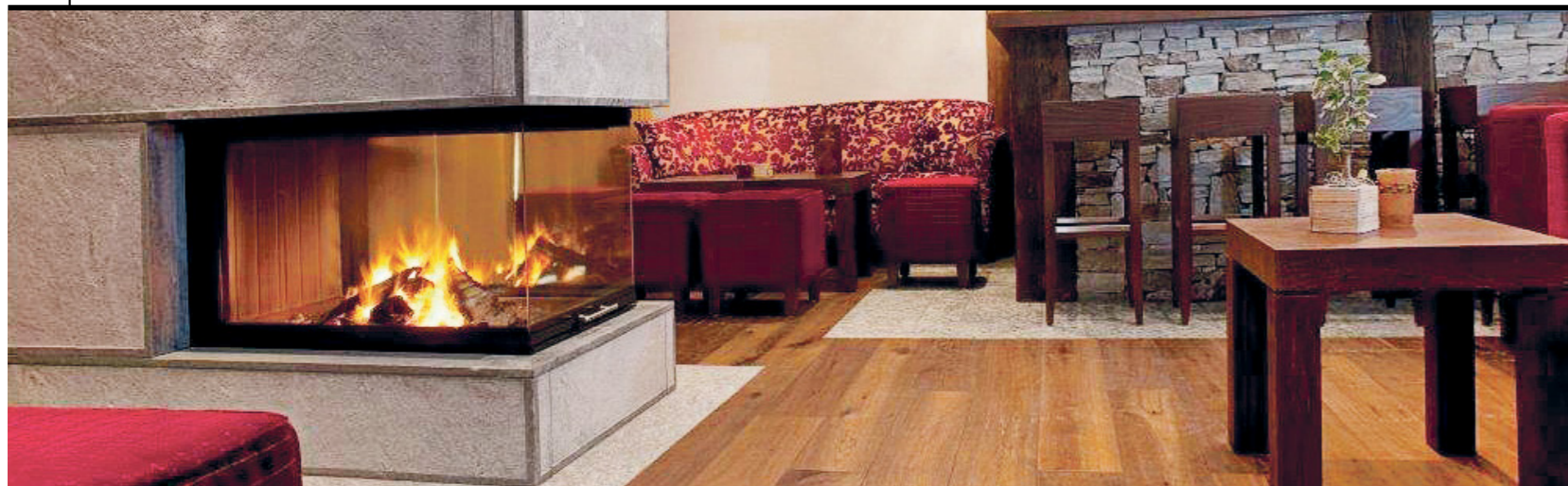
Ein moderner Giltsteinofen in einem Hotel in Zermatt.
